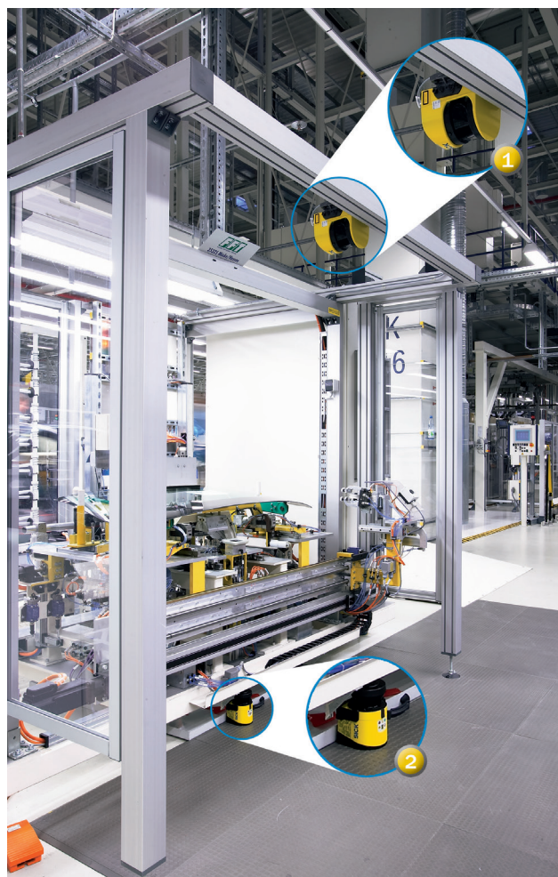
Abbildung 80: Sicherheitslaserscanner an einer Bearbeitungsstation als Sicherheitsfunktion Pos. 1, Stopp auslösen und Sicherheitsfunktion Pos. 2, Start verhindern (Hintertretschutz)
